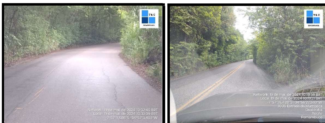
Fotografia 9 – Em vários trechos da PE-016, se apresentam sem acostamento e sem local para o deslocamento de pedestres.
