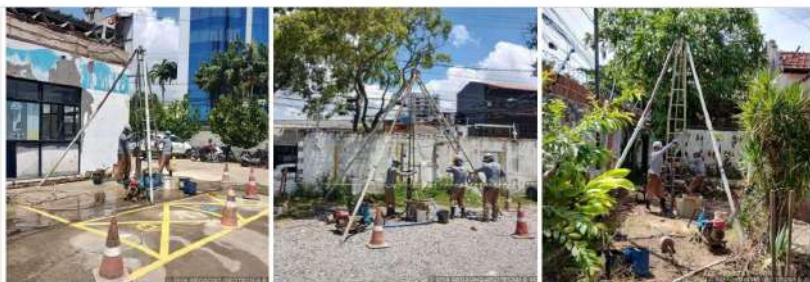
Mosaico 1 – Imagens da execução de sondagens por parte da GEOSOND em março de 2024. Fonte: GEOSOND,2024.
