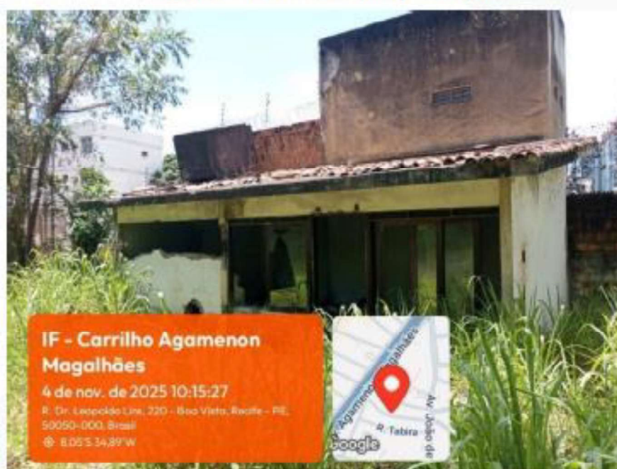
Figura 13 - ruínas de área de serviço.
