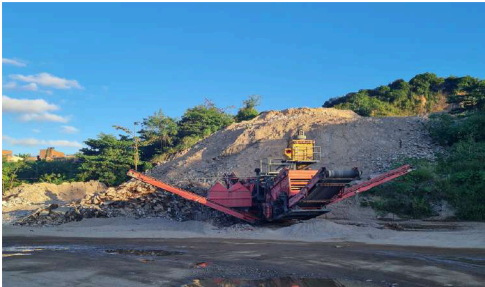
Figura 54: Britador na usina de beneficiamento de RCC
